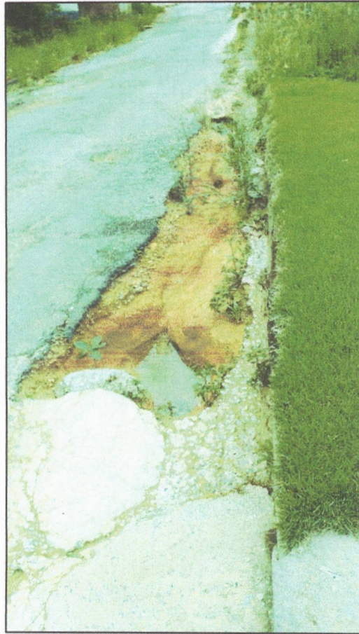
Foto 1 – Grande buraco na rua Giroscópio, próximo ao número 250, bairro Escarpas do Lago
